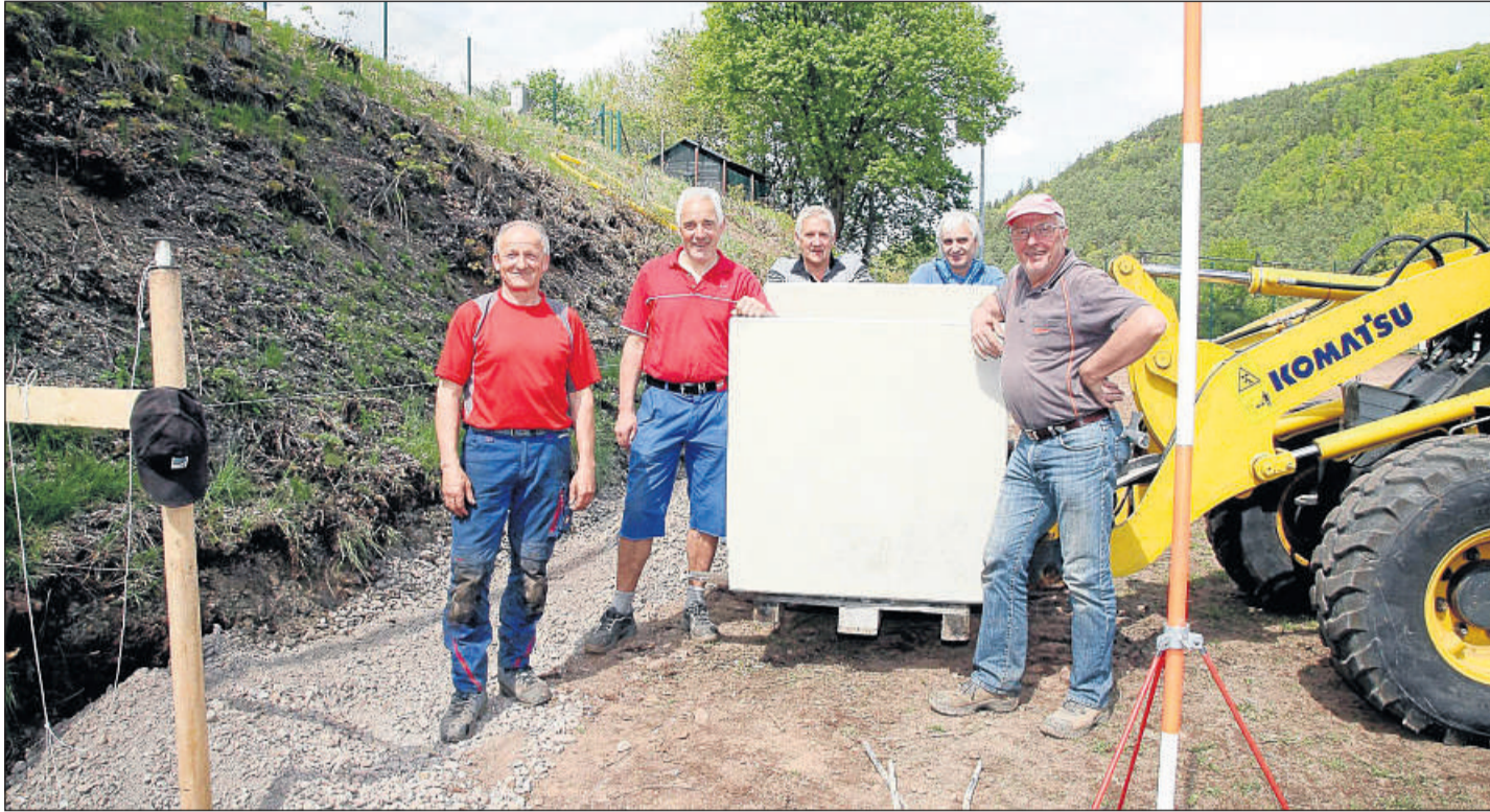
Die Arbeiten für den Umbau des Aschenplatzes am Entenpark in Battenberg haben begonnen: Im Bild (von links) Hartmut Balzer, TSV-Vorsitzender Burkhard Specht, Wolfgang Werth, Fußball-Abteilungsleiter Eckhard Arnold und Günther Olbert. Foto: Hoffmeister
